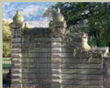
La végétation a pris possession de l'édifice accélérant les dégradations.
